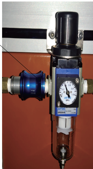
图 4-23 调节调压过滤器旁边的手滑阀
